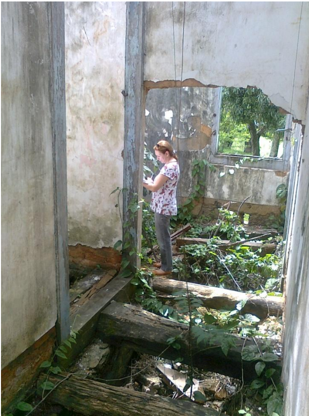
Foto 5 – A parte inferior da parede interna em tijolinho indicia ter sido derrubada, uma vez que a estrutura e a parte superior da mesma se encontram em bom estado.
