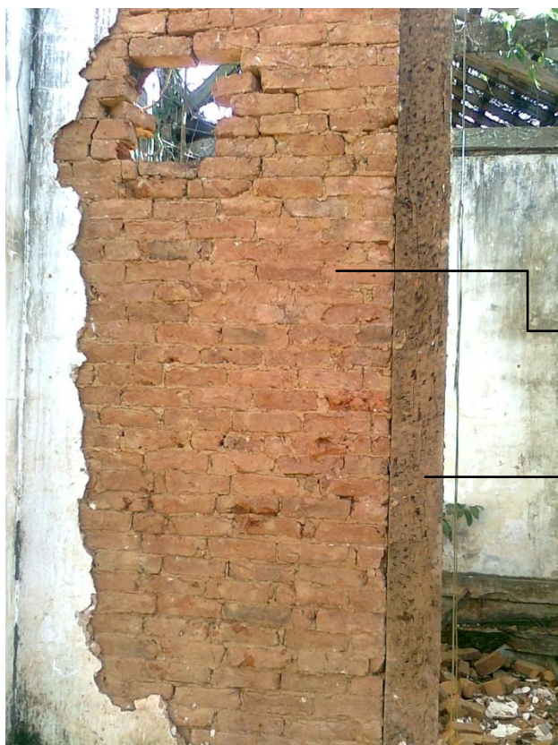
Foto 4 – (A) Parede interna em tijolinho queimado. (B) Aduela da porta picada para facilitar a aplicação do reboco.
